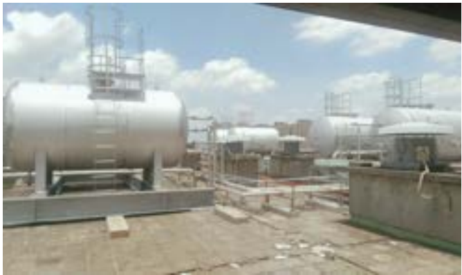
▼ 學生宿舍熱泵供應熱水裝置
